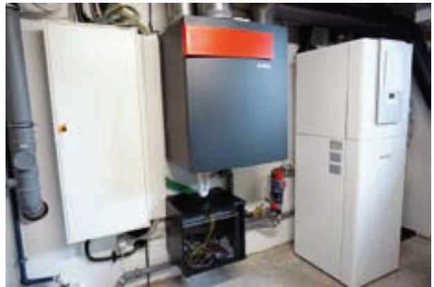
Abb. 5 Heizraum mit Wärmepumpe und Lüftungsgerät mit Wärmerückgewinnung © SAENA
