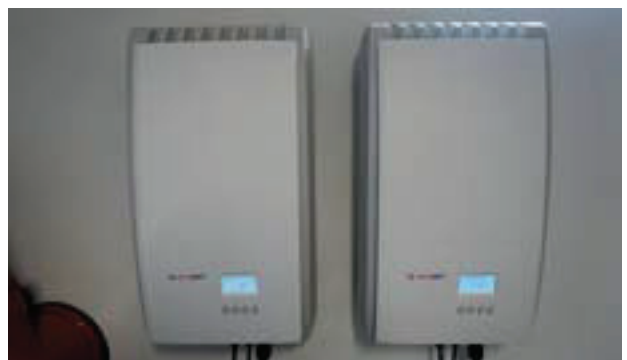
Abb. 8 Wechselrichter der Photovoltaikanlage © SAENA
