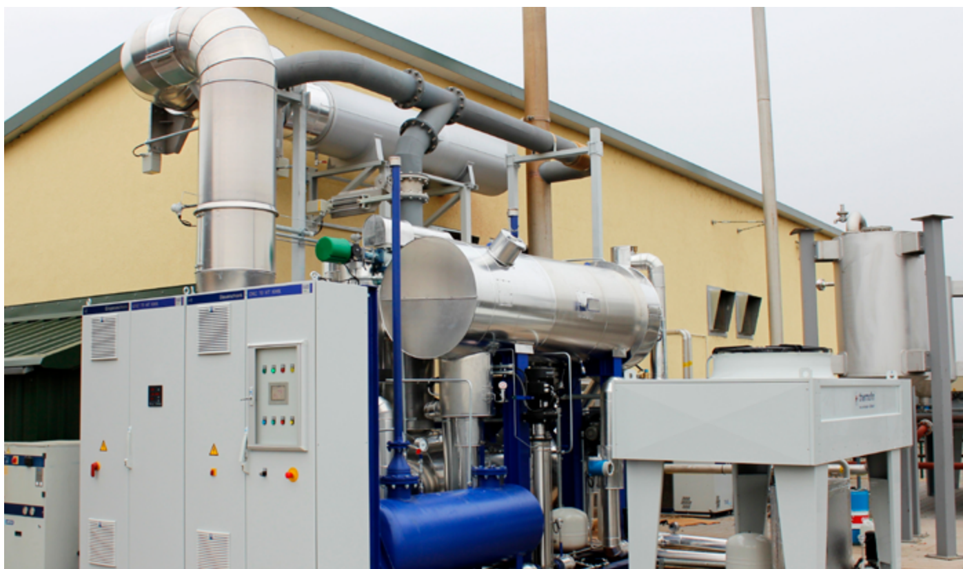
ORC-Anlage (70 kW elektrisch, von Dürr Cyplan) zur Nutzung der Abgaswärme eines Biogas-Blockheizkraftwerks.
