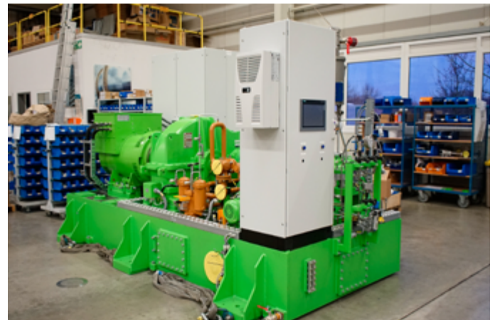
5-stufige Mini-Kondensationsturbine von M+M Turbinen-Technik, 350 kWel
