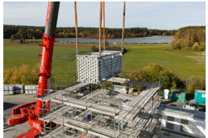
Fa. Leonhard Kurz in Sulzbach-Rosenberg: Einbringung eines thermischen Speichers für eine Prozessanlage zur Thermalölerhitzung, Hersteller: ENERGYNEST
