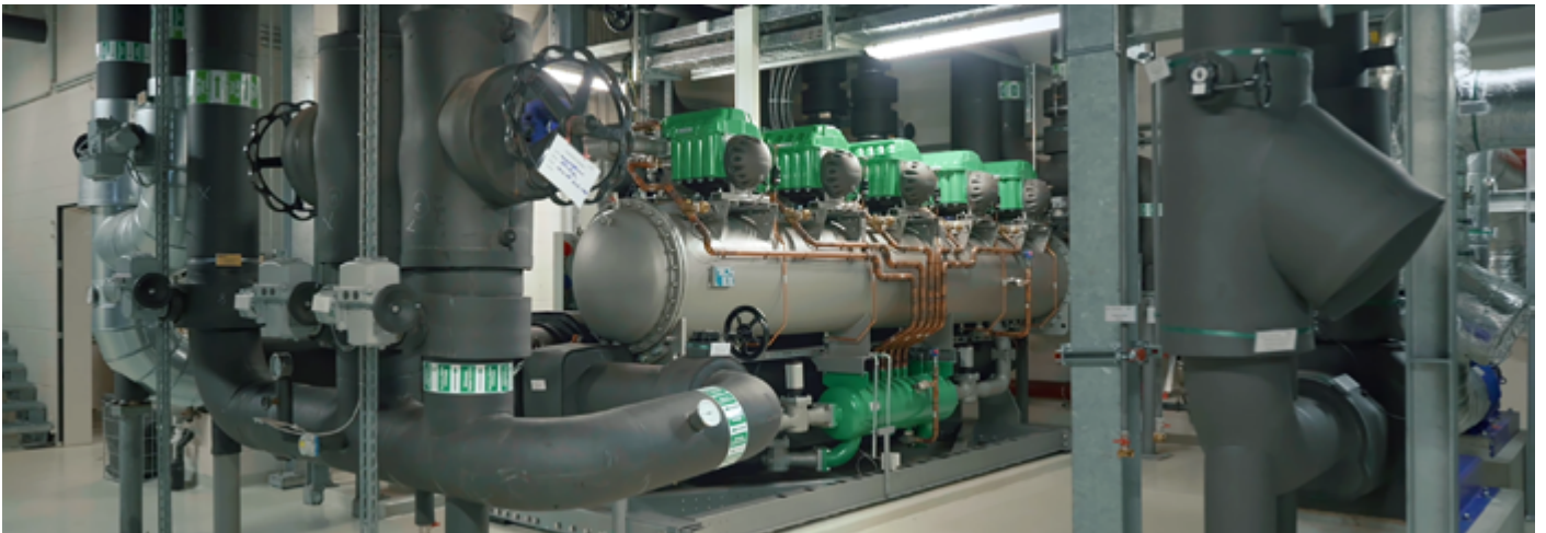
industrielle Großwärmepumpe im Einsatz, Standort Dresden
