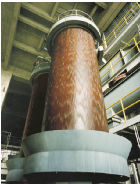
Zwei Feingutkühler in einer Zementmahlanlage, thyssenkrupp Polysius GmbH
