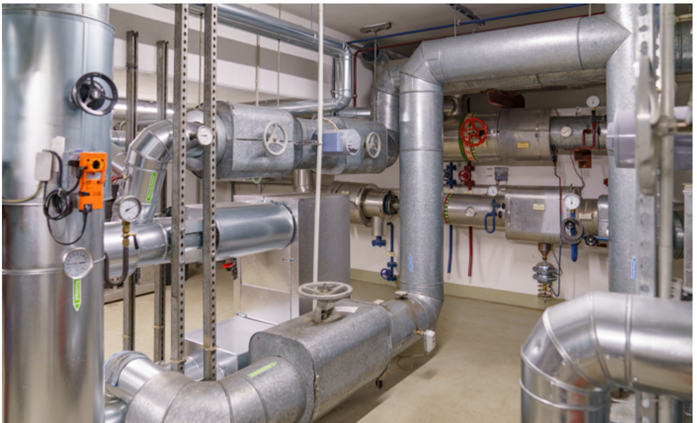
Übergabe Fernwärme in einer Heizzentrale; SAENA 2025
