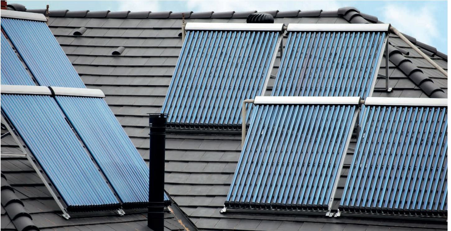
Abbildung 52: Kollektoren einer Solarthermieranlage
