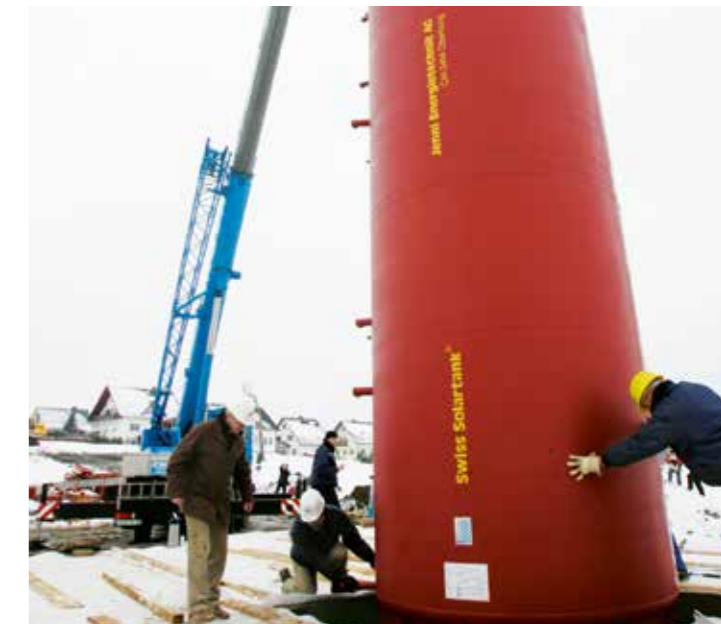
Abb. 17: Installation eines großen Pufferspeichers
