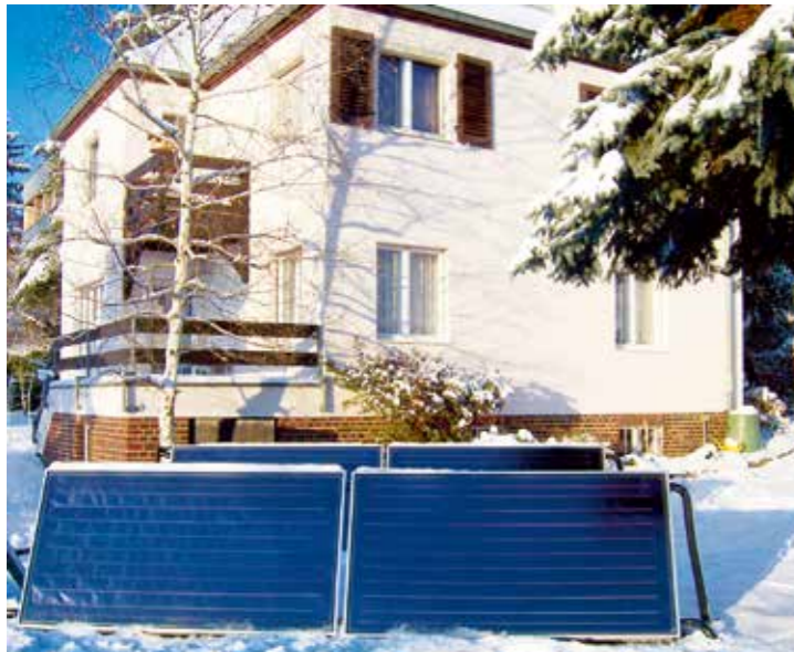
Abb. 6: Aufgeständerte Solarkollektoren im Vorgarten
