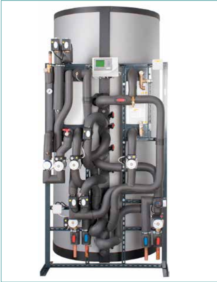
Abb. 8: Pufferspeicher mit gesamter Solartechnik für Heizung und Warmwasser
