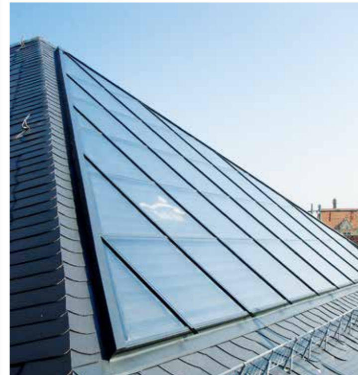
Abb. 7: Anlage mit schräg geschnittenen Kollektoren
